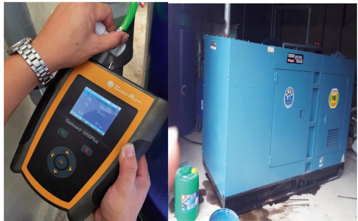
Hình 8. Máy phát điện được lắp tại trang trại
